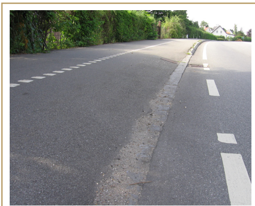
Dykkede kantsten og smalle cykelstier er en dårlig kombination.
