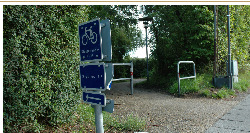
Manglende afmærkning af bomanlæg samt defekt skiltning er eksempler på "mindre tiltag", der kan udbedres uden fornyet plangrundlag
