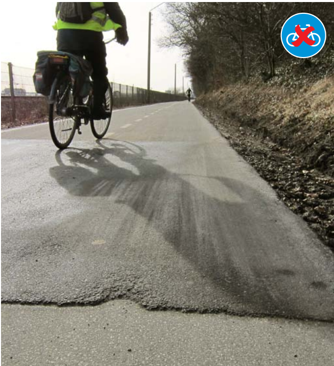
En reetablering udført med alt for høj kant. ▲
