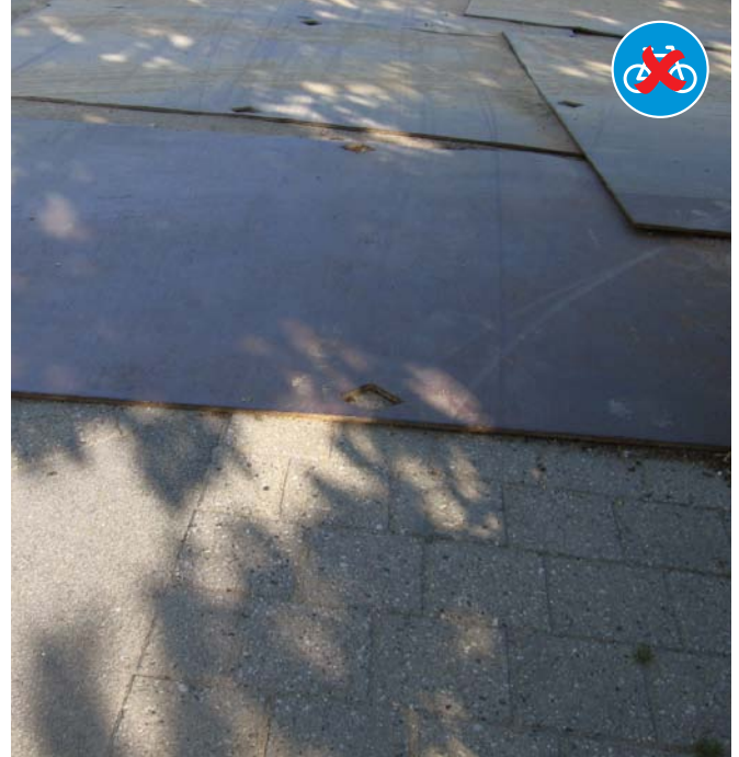
Dækplader med høje og skarpe kanter udgør en sikkerhedsmæssig risiko for cyklister. ▲
